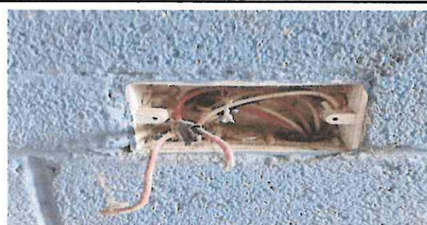
Foto 5: Cableado electrico en mal estado
