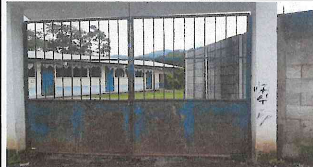
Foto 2: Portón en mal estado
