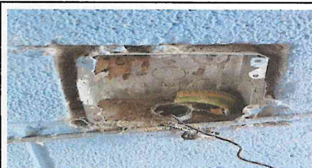
Foto 4: Falta de toma corrientes en salones
