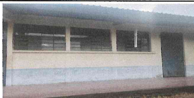
Foto 3: Falta de balcones en ventanas
