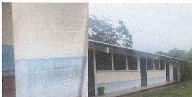
Foto1: Pintura de muros interior y exterior en mal estado
